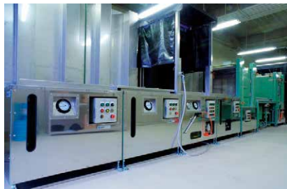
(a) 浸透探傷装置 (PT)
